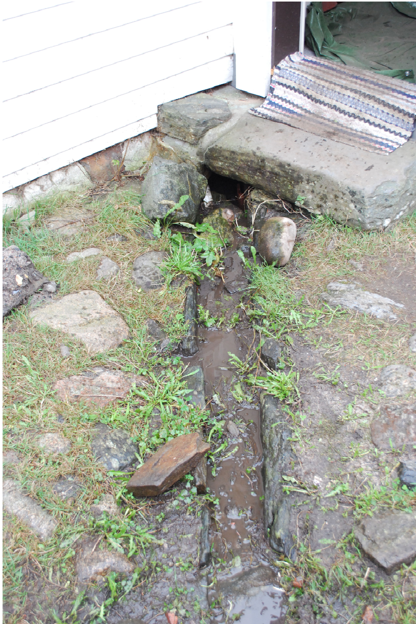
Figur 17 Kanalens plassering på gårdsplassen. Den strekker seg under inngangspartiet til bygningen. Kantstilte heller kan tydelig ses på hver side av kanalen.
