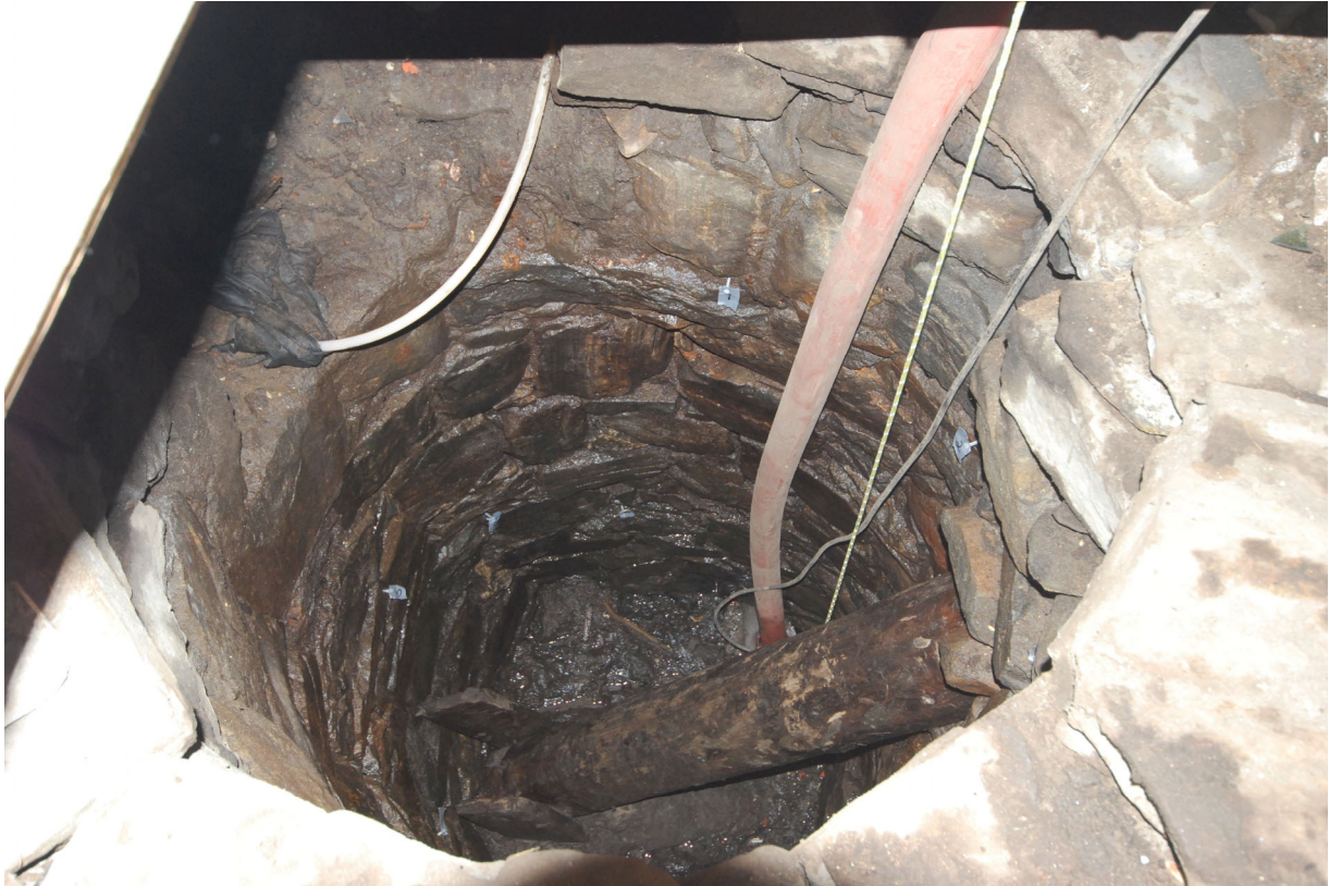
Figur 16 Stammens plassering i brønnen. To plankebitene kan ses til venstre i bildet, og hvordan stammen har kilt seg inn i veggen til høyre. Rød slange er koblet til pumpen.
